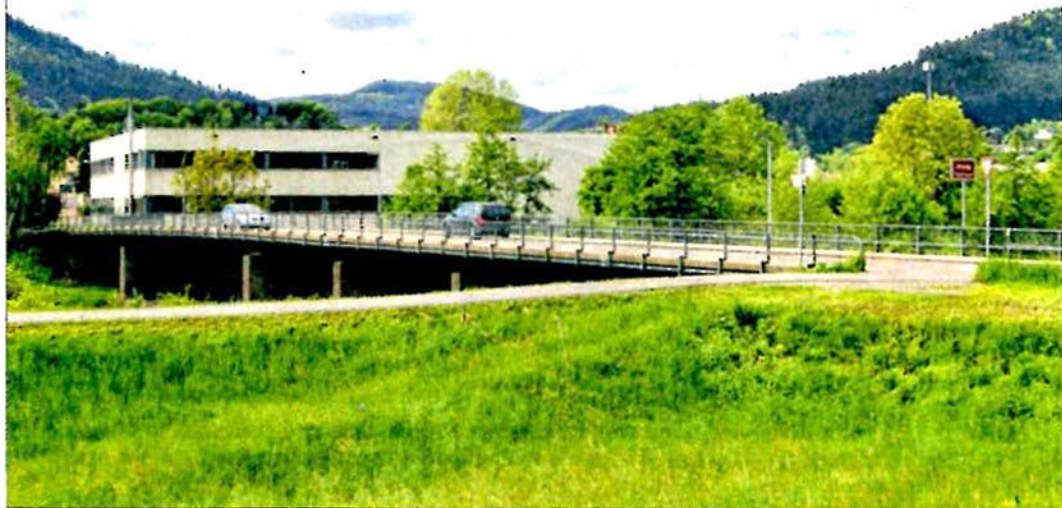
Die »Arche-Brücke« zwischen Haslach-Schnelllingen und Schleifmattstraße dient von Fischerbach als Zufahrt ins Haslacher Gewerbegebiet Mühlegrün. Sie ist sanierungsbedürftig. Foto: M. Pagel
